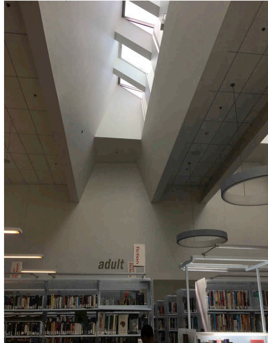
Fortluft über Oblichter mit Lüftungsflügel
